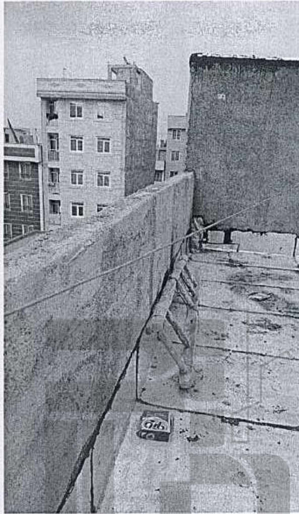
شکل ۱۱ - عدم اجرای پشت بند و درپوش جانپناه بام
