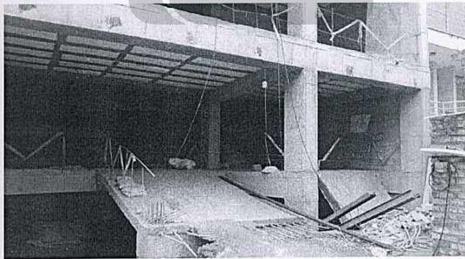
شکل ۱۲ - عدم وجود نرده موقت و پاخور در اطراف پرتگاه راه پله
