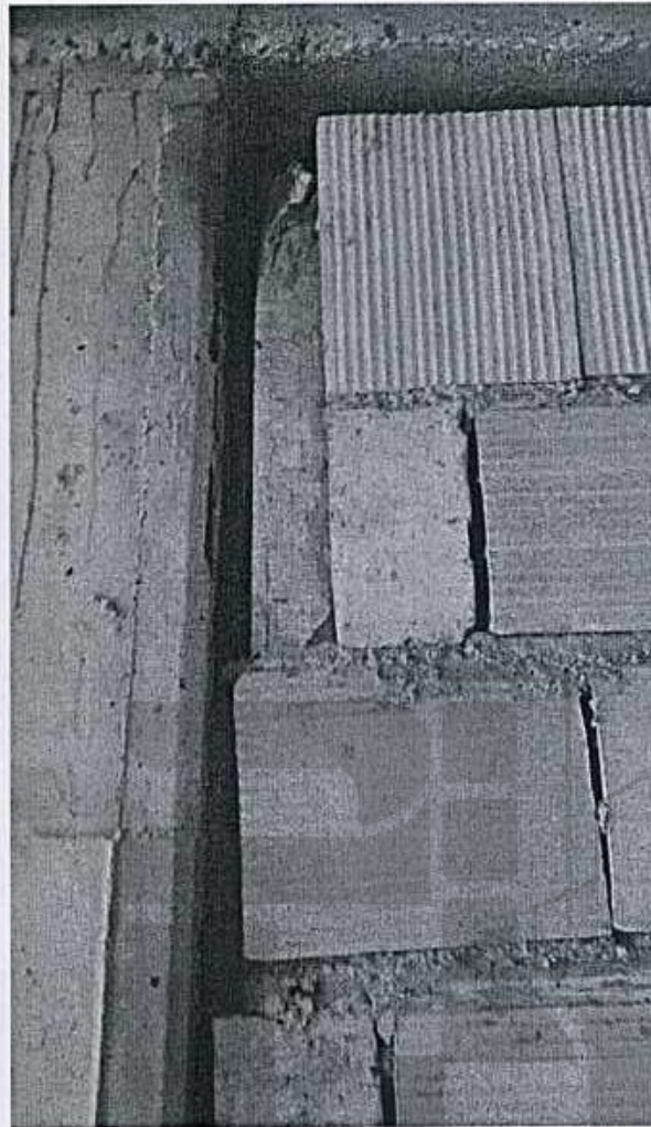
شکل ۱۵- عدم درزبندی صحیح و عدم اجرای بندکشی قایم دیوار بین واحد های مستقل از لحاظ عایق بندی صوتی
